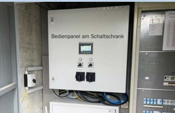
Steuereinheit des Pumpwerks, integriert in die Unterverteilung
