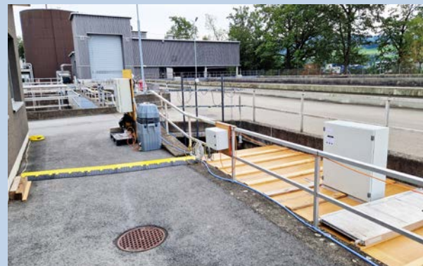
Messstelle Zulauf Biologie («Pollution Keeper»)
