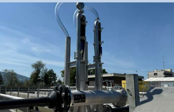
Zyklon zur Schlammfraktionierung (aussen aufgestellt)
