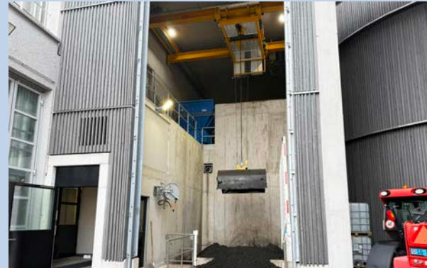
Brun-Marty-Dytan-Krananlage und Schlamm-bunker
