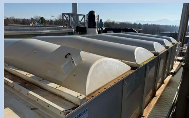
Tholander-Abluftreinigung (Wäscher/ im Bild: Biofilter/ Aktivkohle)
