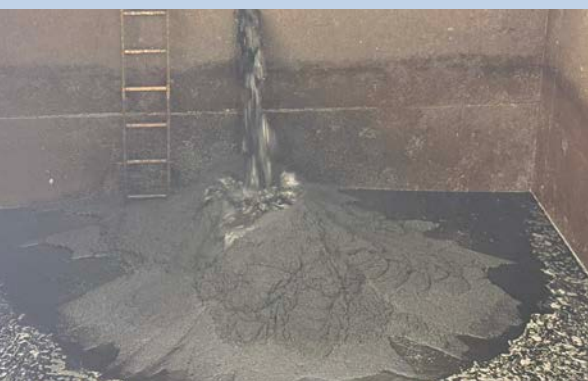
Befüllung eines GAK-Filters im AVA
