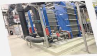
Wärmenutzung mittels Wärmetauscher aus dem Abwasser der ARA Altenrhein
