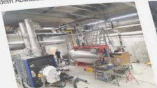
Backup Notkessel zur Spitzendeckung oder für Ersatz bei Ausfällen WT-Anlage
