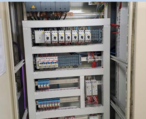
Alte und neue Motorsteuerplatten in der Unterwarte Festbett-Biologie
