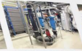
Wärmepumpen-Anlage zur Wärmerückgewinnung aus der Trocknerabluft
