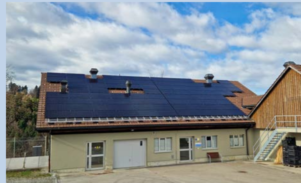
Installierte PV-Anlage in Trogen
