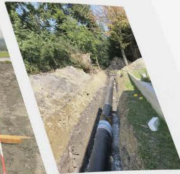
Im Bau befindliche, gut isolierte und geschützte Vor- und Rücklaufwärmeleitungen, die von der ARA bis ins Industriegebiet Buriel führen.
