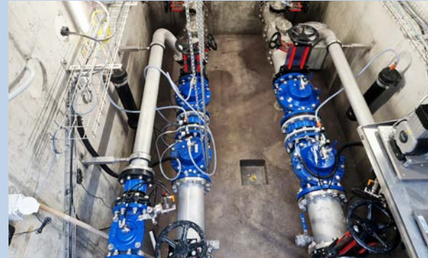
Redundante Magnetquetschventile auf den zwei Düker- und Bypassleitungen
