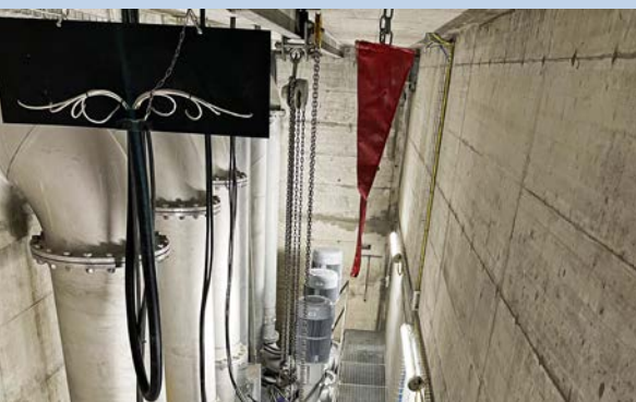
Blick in den Pumpenkeller, PW Steinlibach
