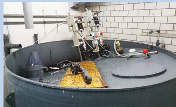
Schräg verkeiltes Tankdach nach dem Schadensereignis
