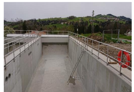
Regenbecken m. Spülkippe
