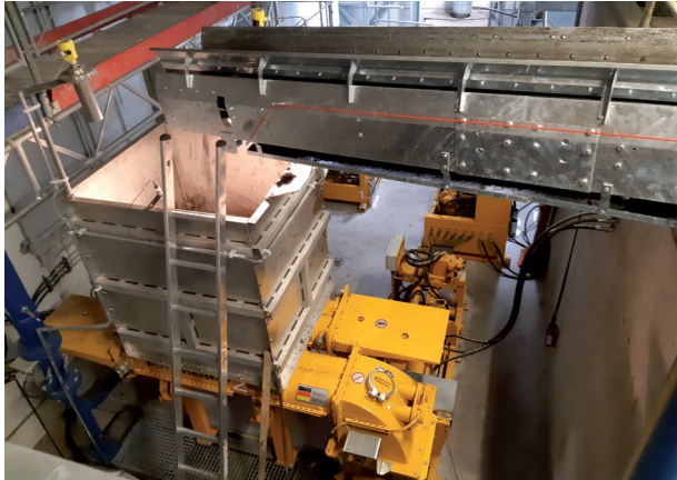
Förderband mit Aufgabetrichter, darunter Dickstoffpumpe
