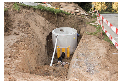
Interventionsschacht in der Steigstrecke des Dükers
