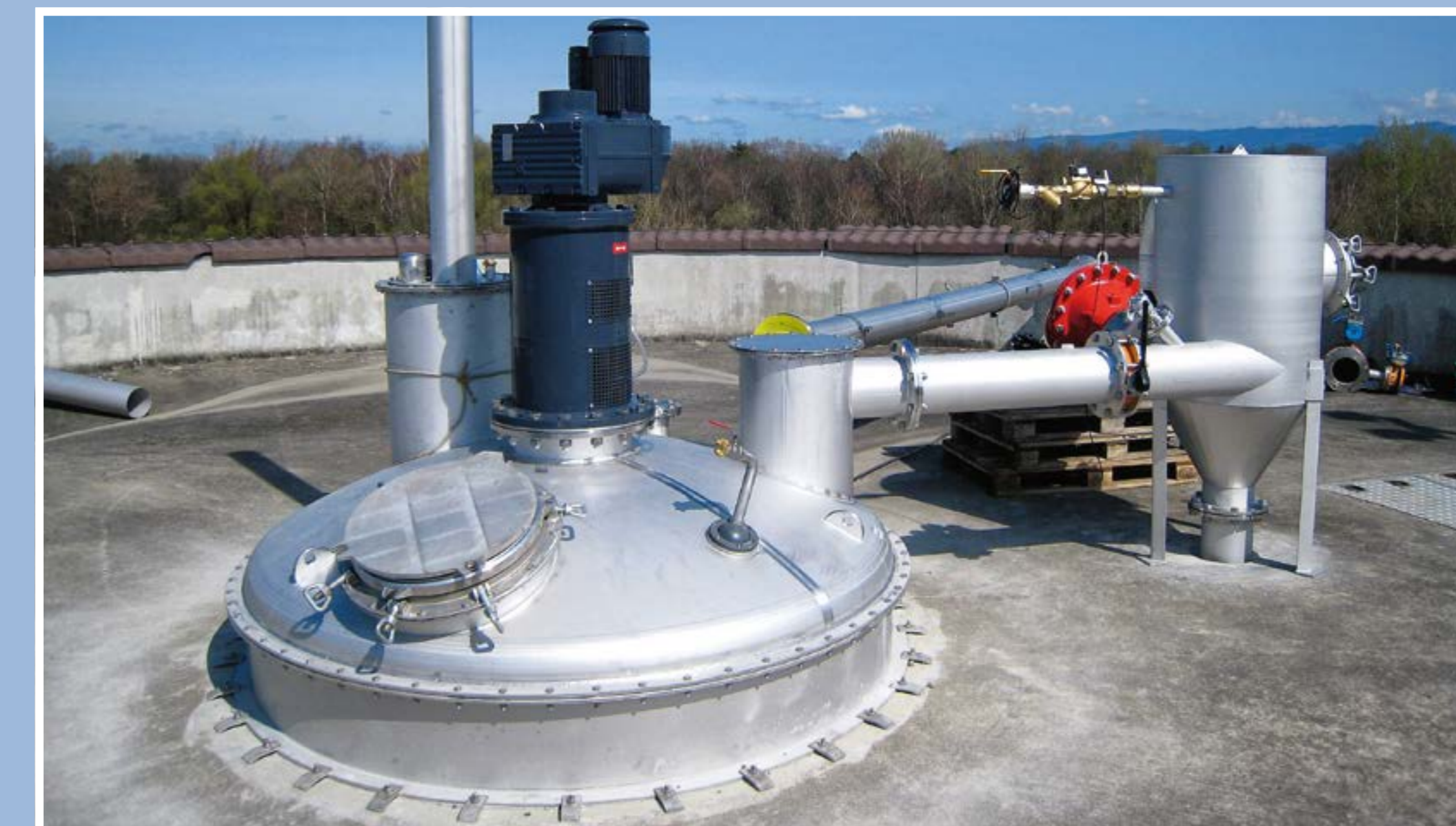
Faulraumdecke mit Rührwerktrieb, Gasabzug und Schaumfalle
