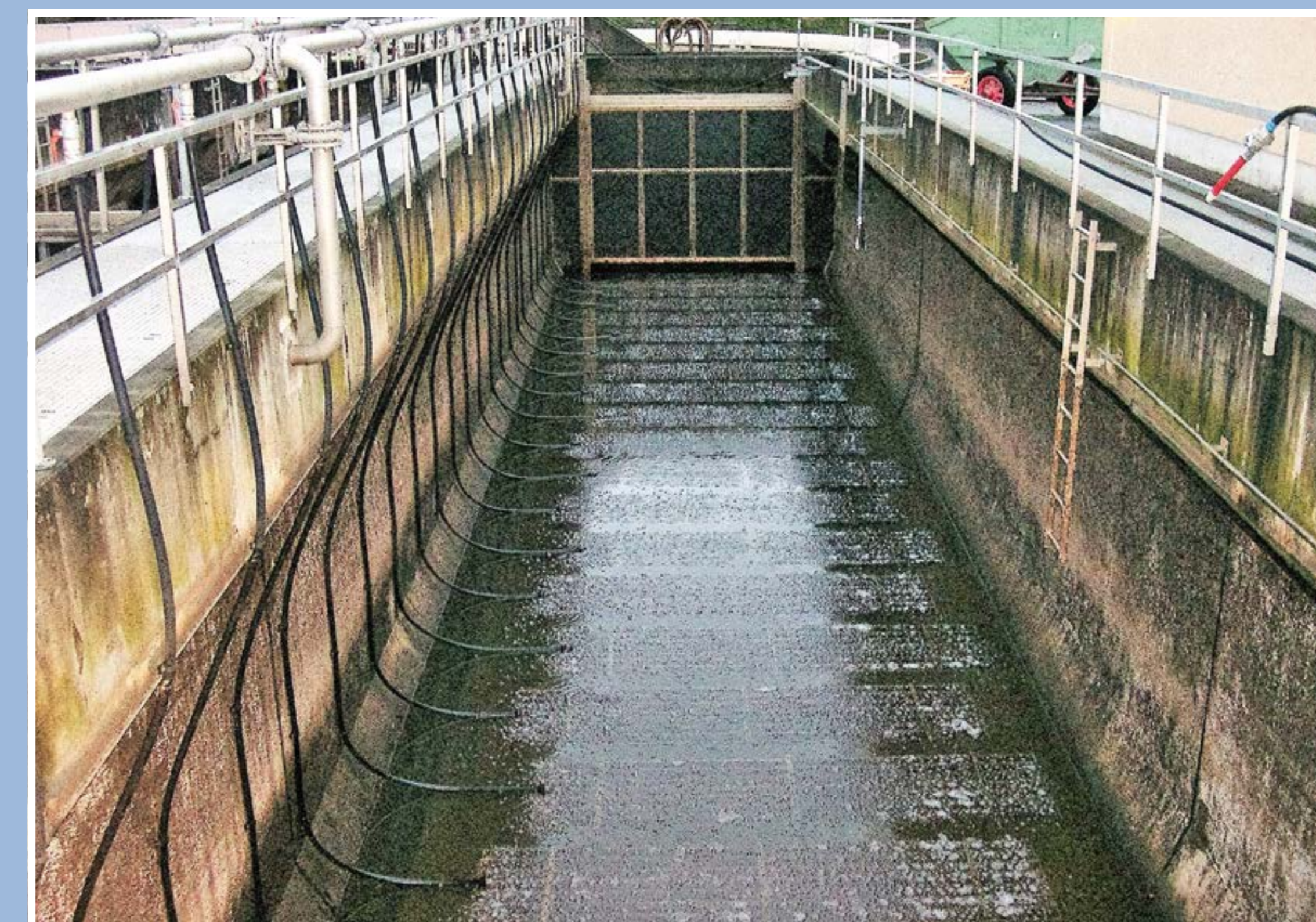
Belebtschlammbecken mit Belüftungsplatten
