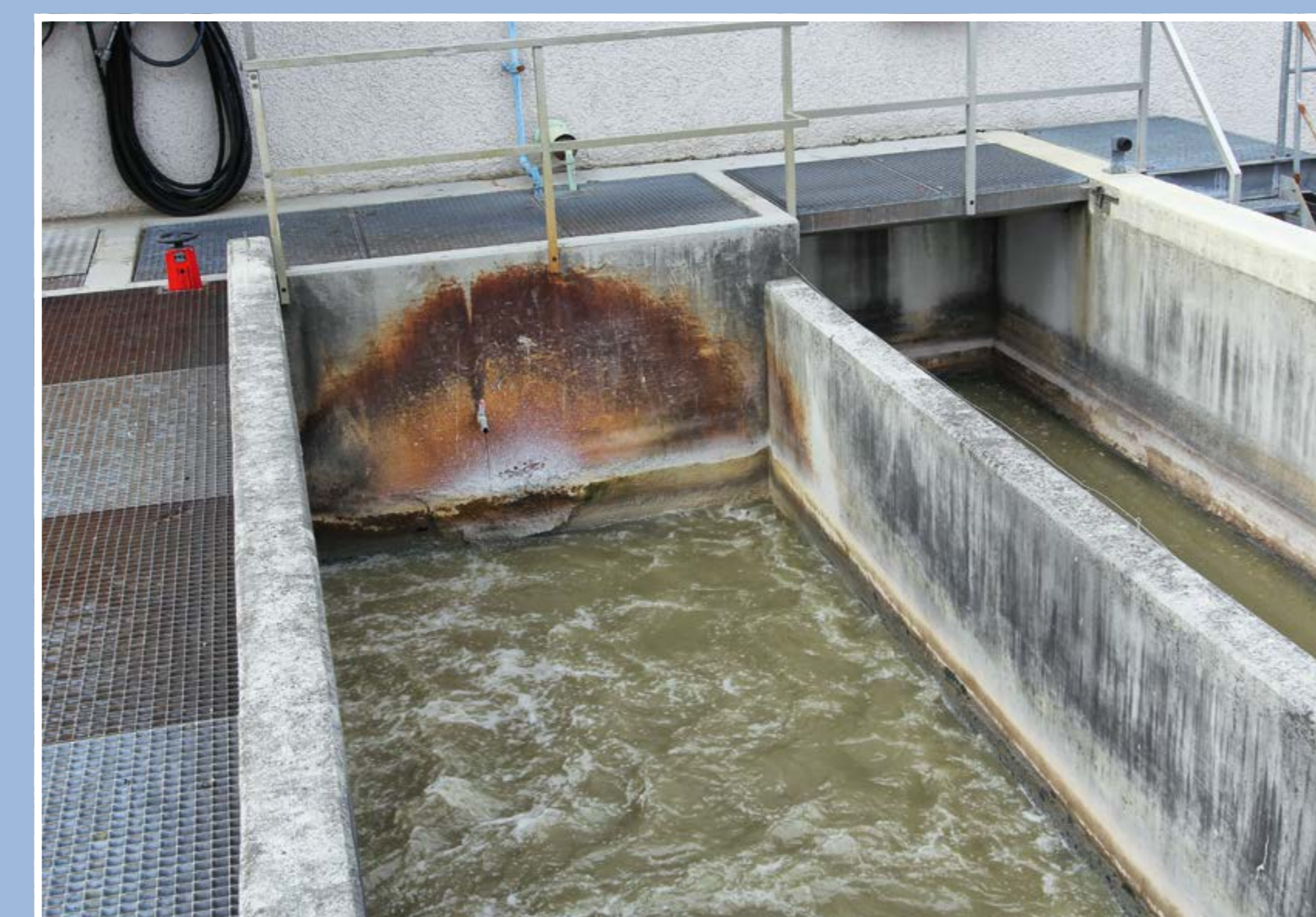
Vorfällung beim Zulauf des Sandfangs
