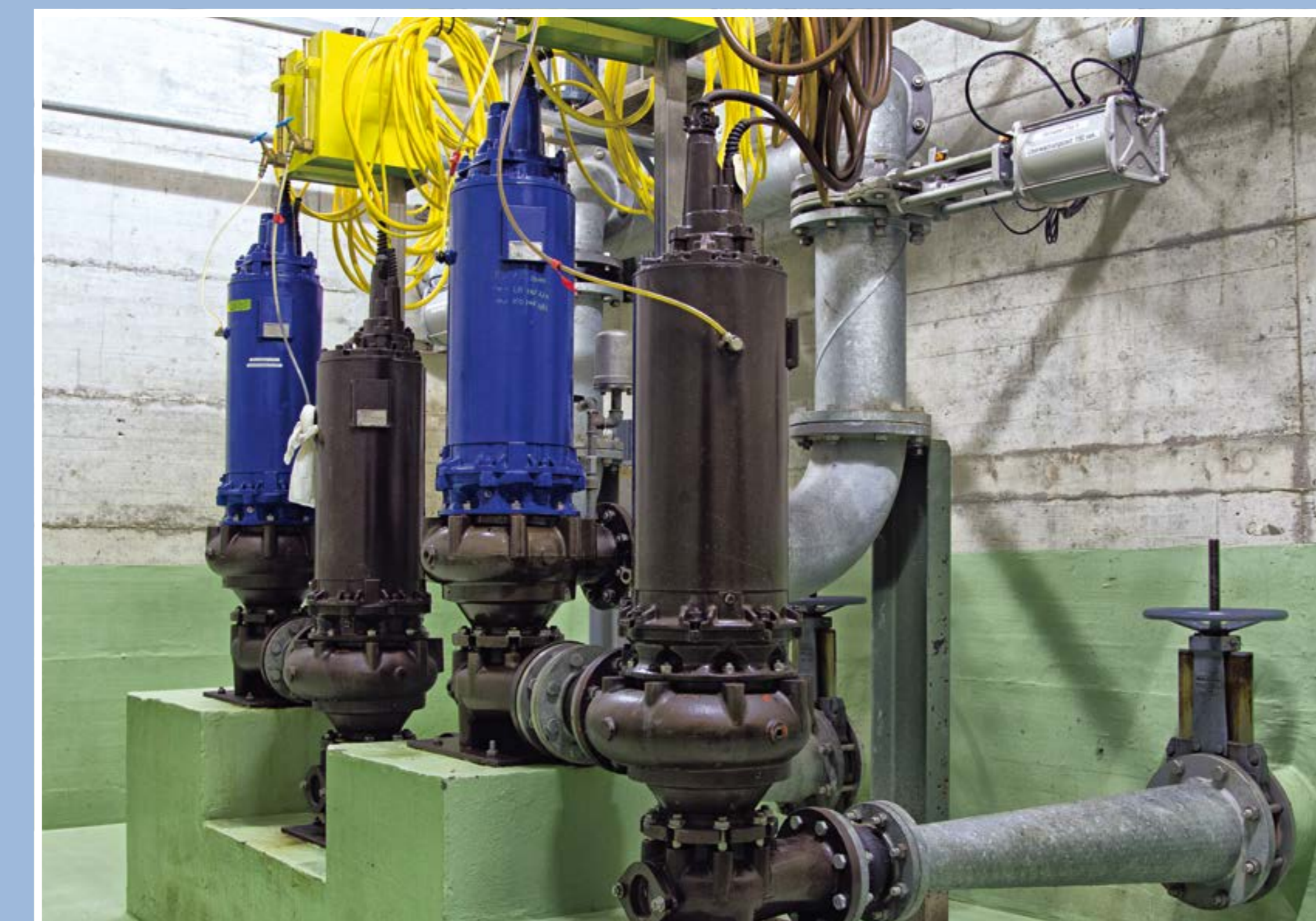
Trocken aufgestellte Pumpen im Aussennetz (Pumpwerk Mülbach in Eggersriet)
