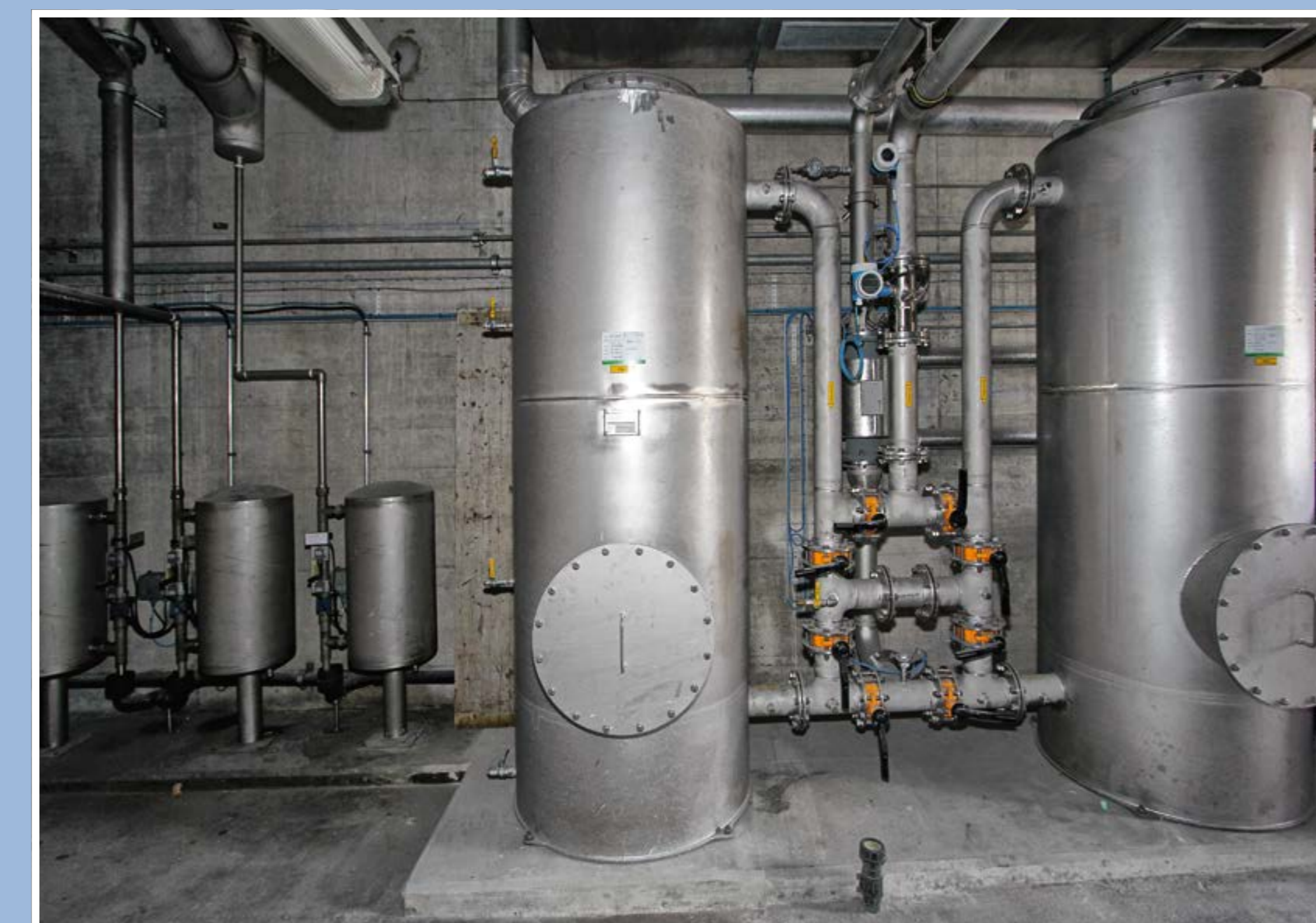
Anlage zur Gasreinigung
