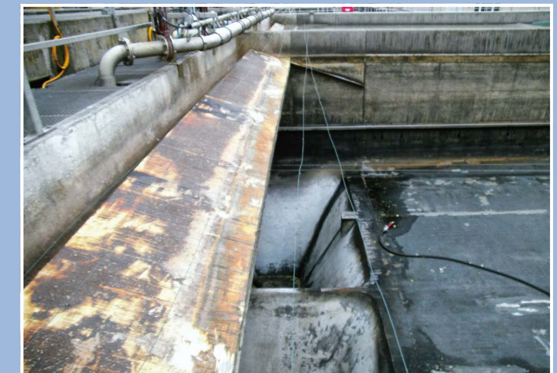
Schwimm Schlammrinne und Schlammtrichter
