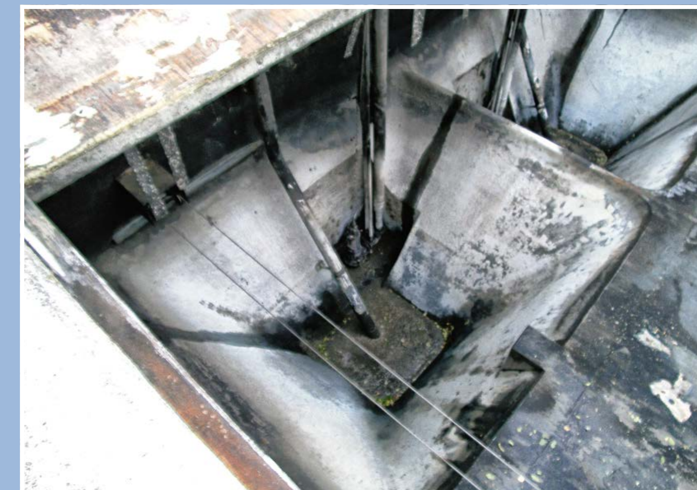
Leerer Schlammtrichter für Schlammmentnahme
