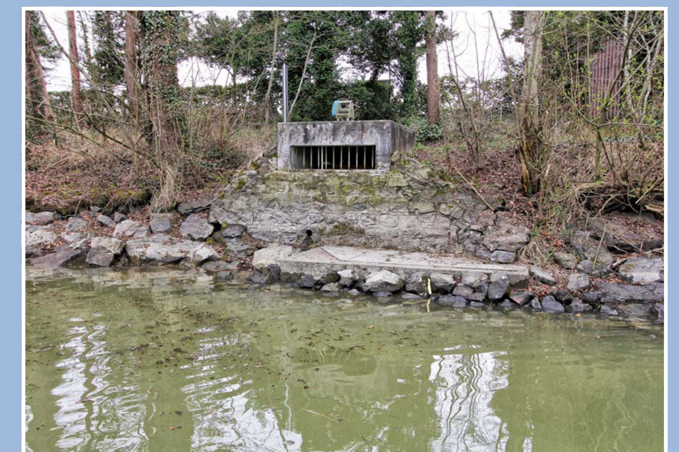
Auslaufbauwerk am Alten Rhein
