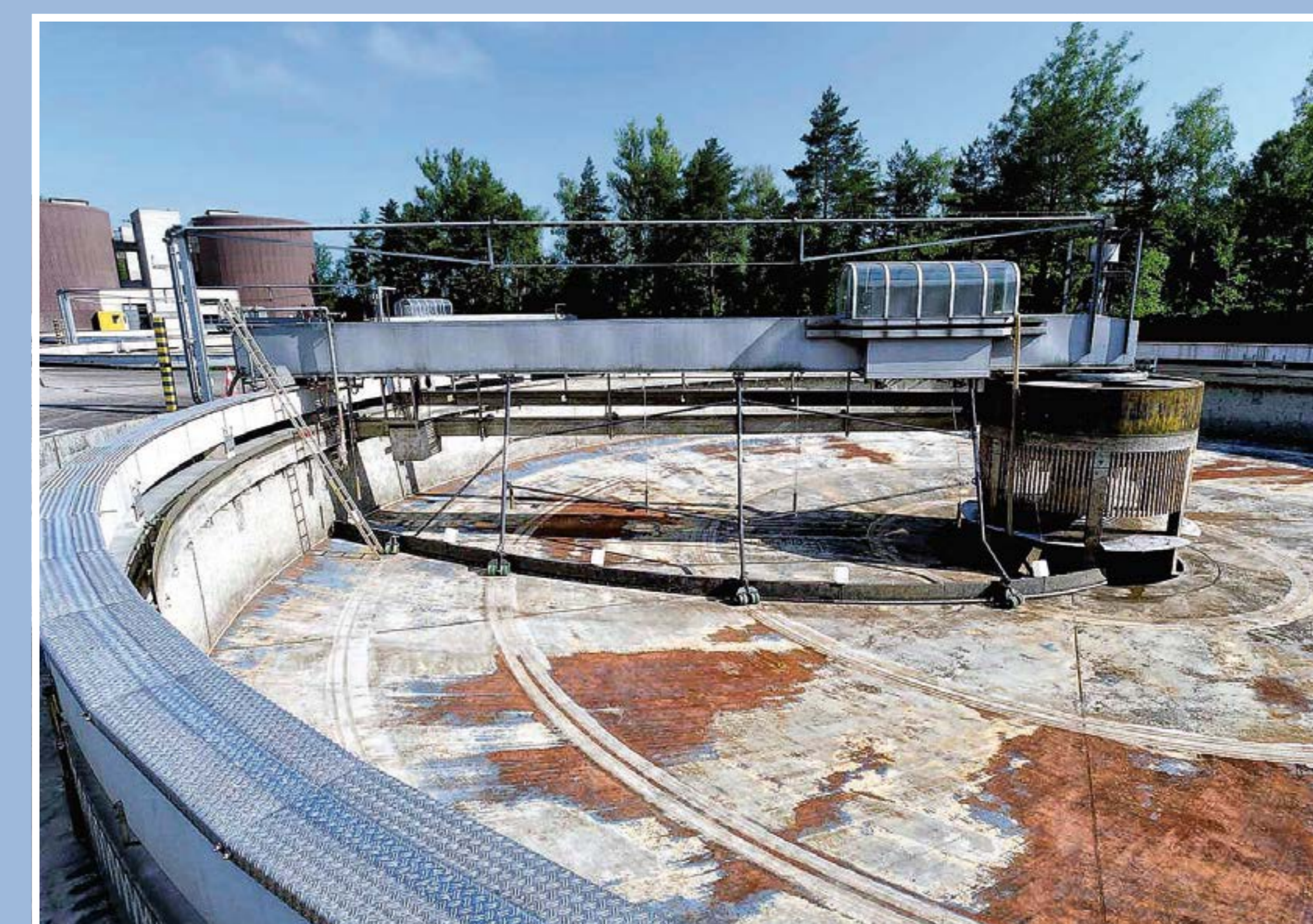
Nachklärbecken mit Räumervorrichtung
