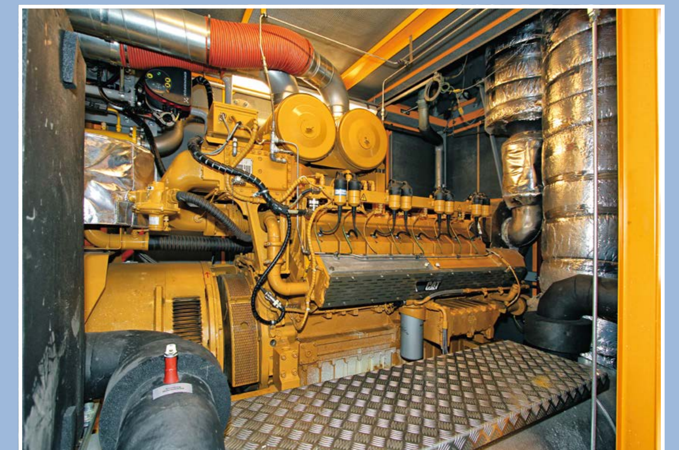
Innenansicht eines Blockheizkraftwerks
