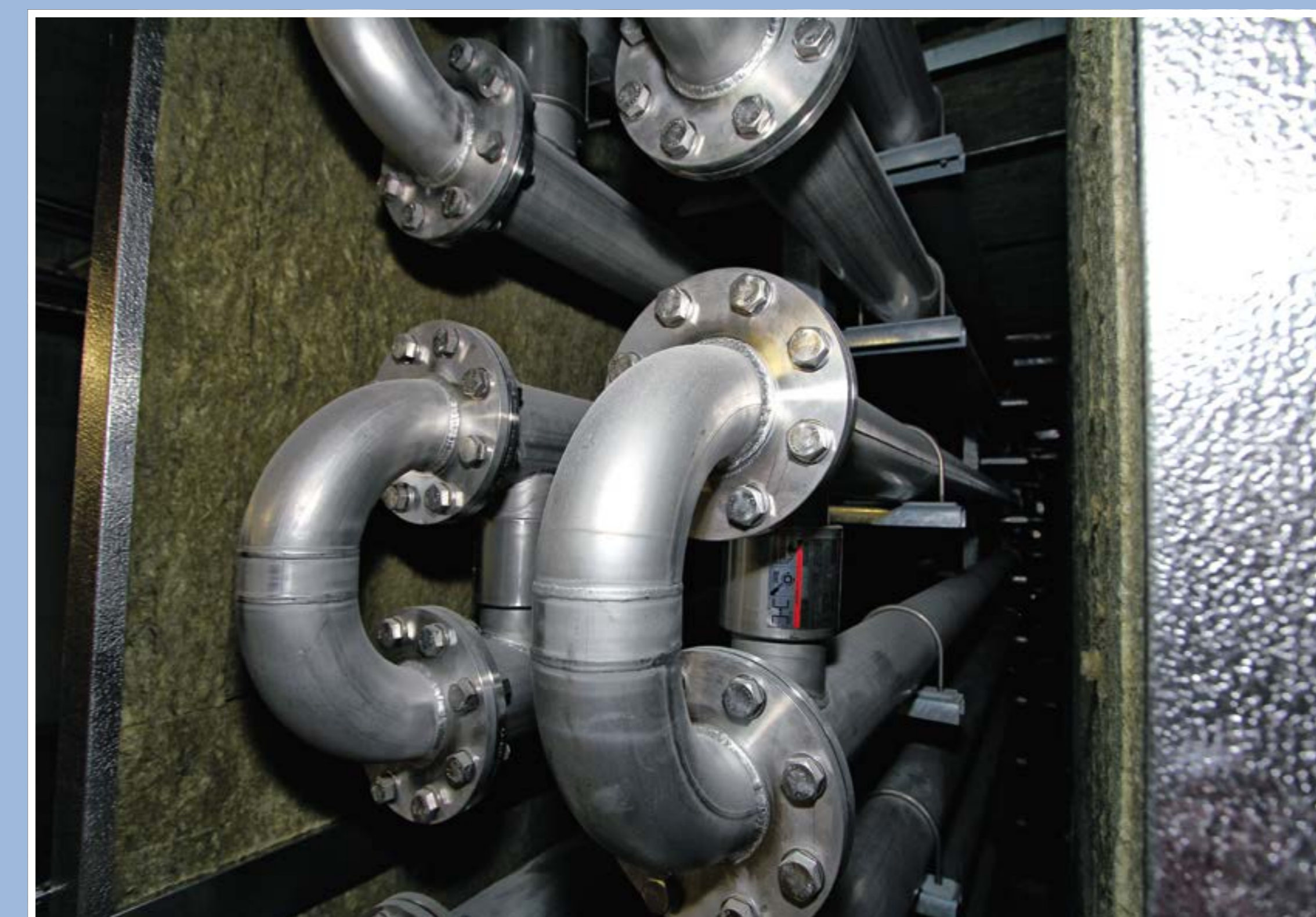
Detail der Wärmetauscheranlage
