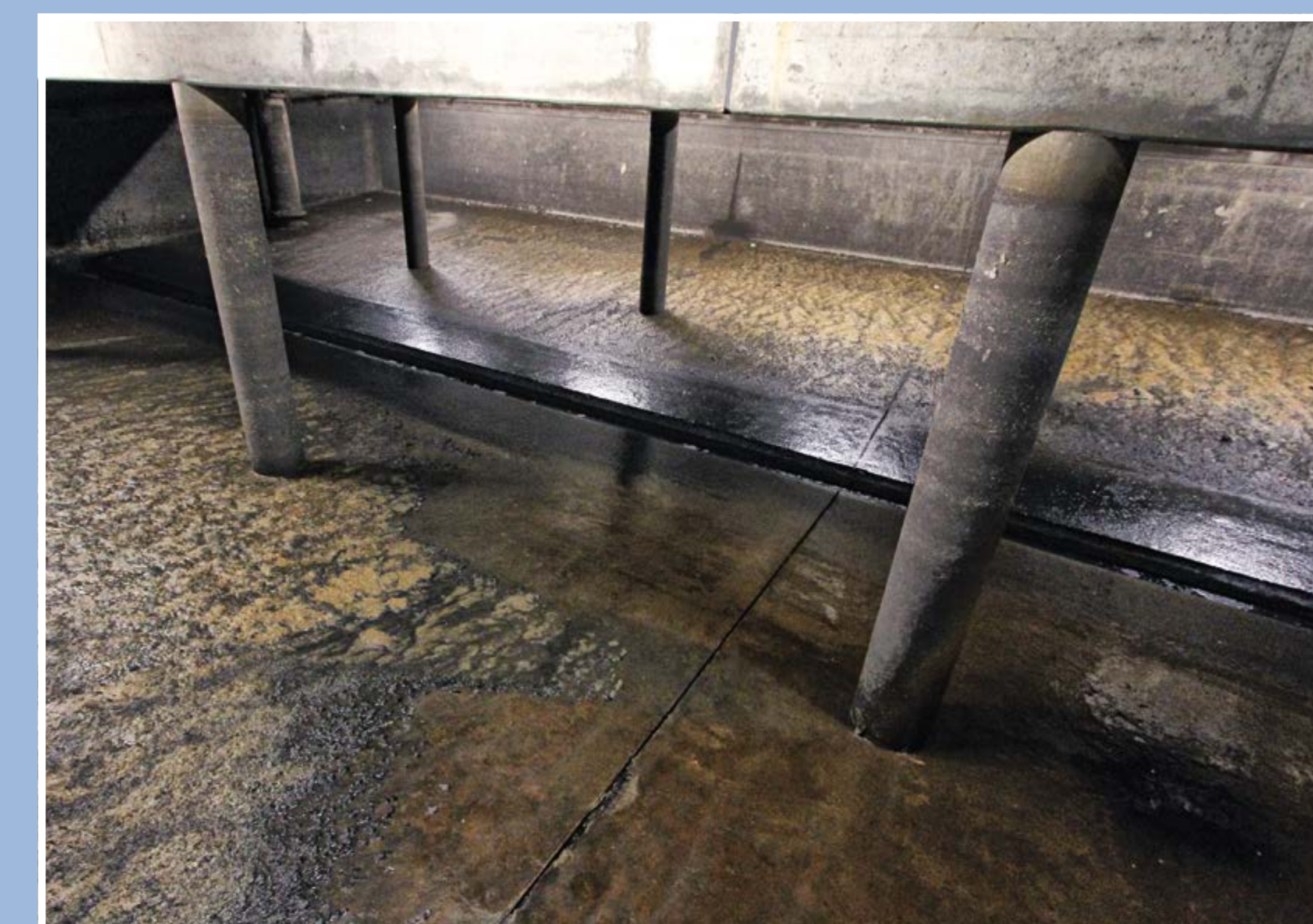
Regenbecken zur Entlastung bei Starkregen
