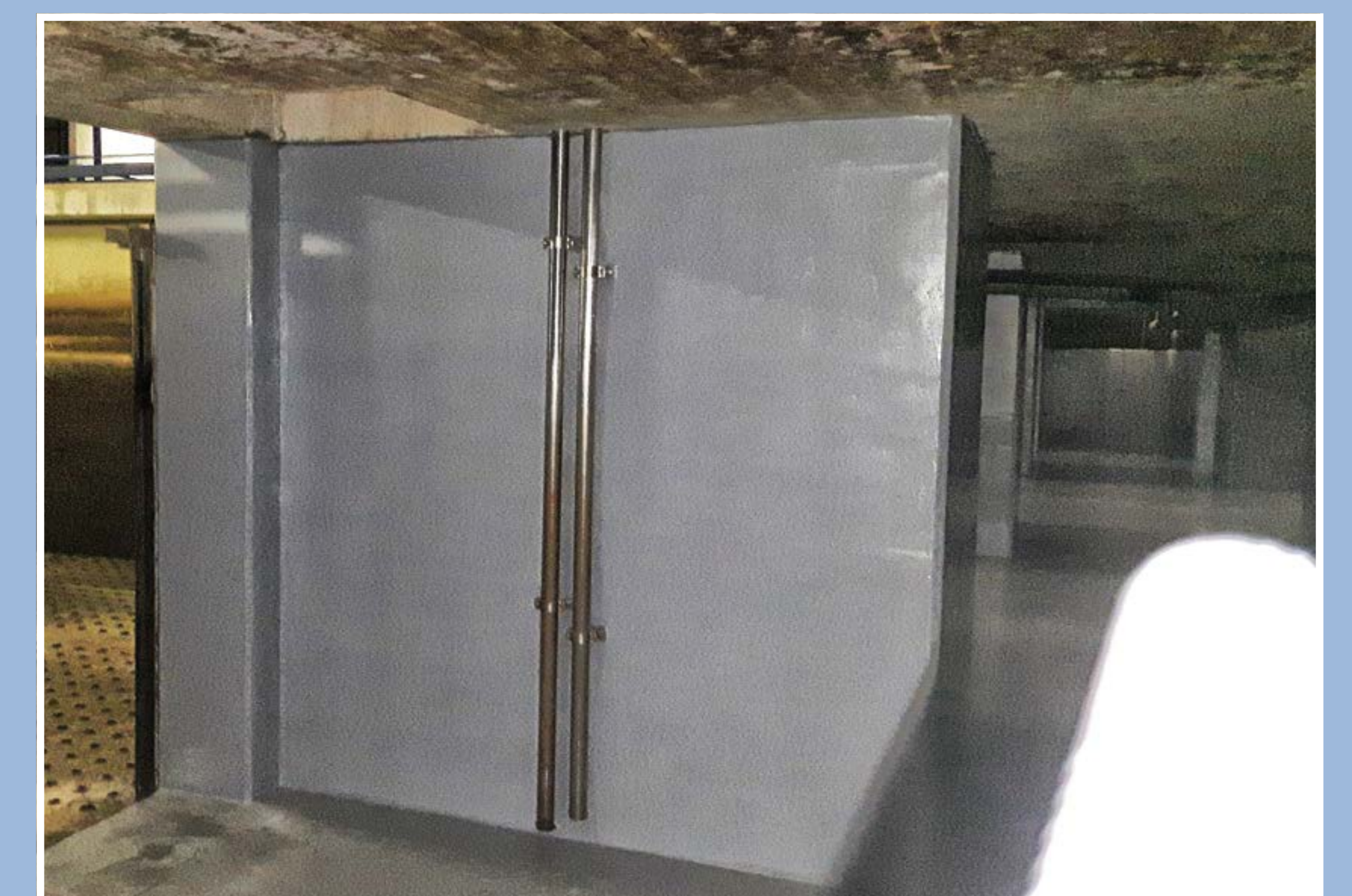
Ablaufkanal von Festbettbiologie zur Sandfiltration
