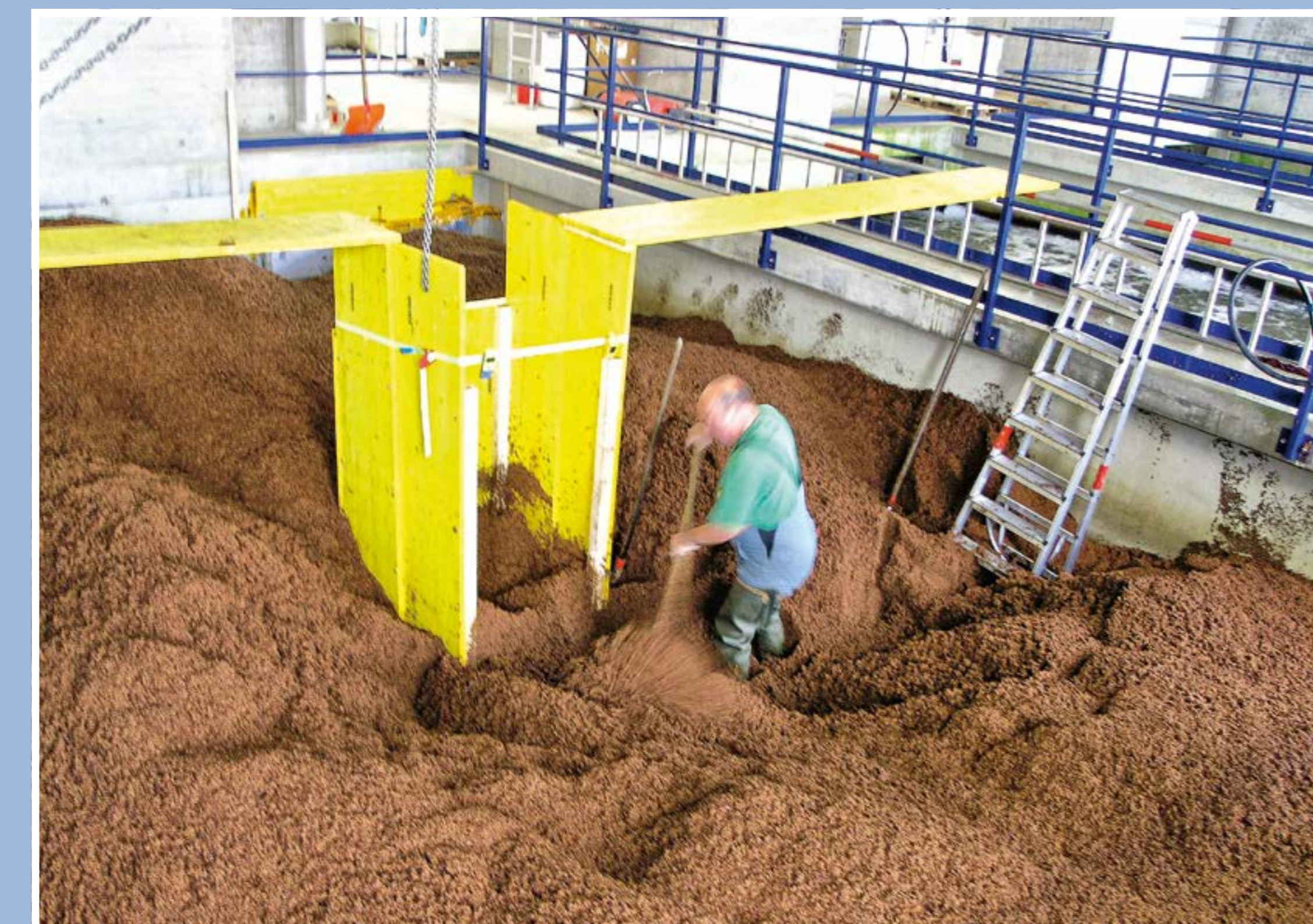
Trägermaterial (Styroporkugeln) beim Leeren einer Zelle
