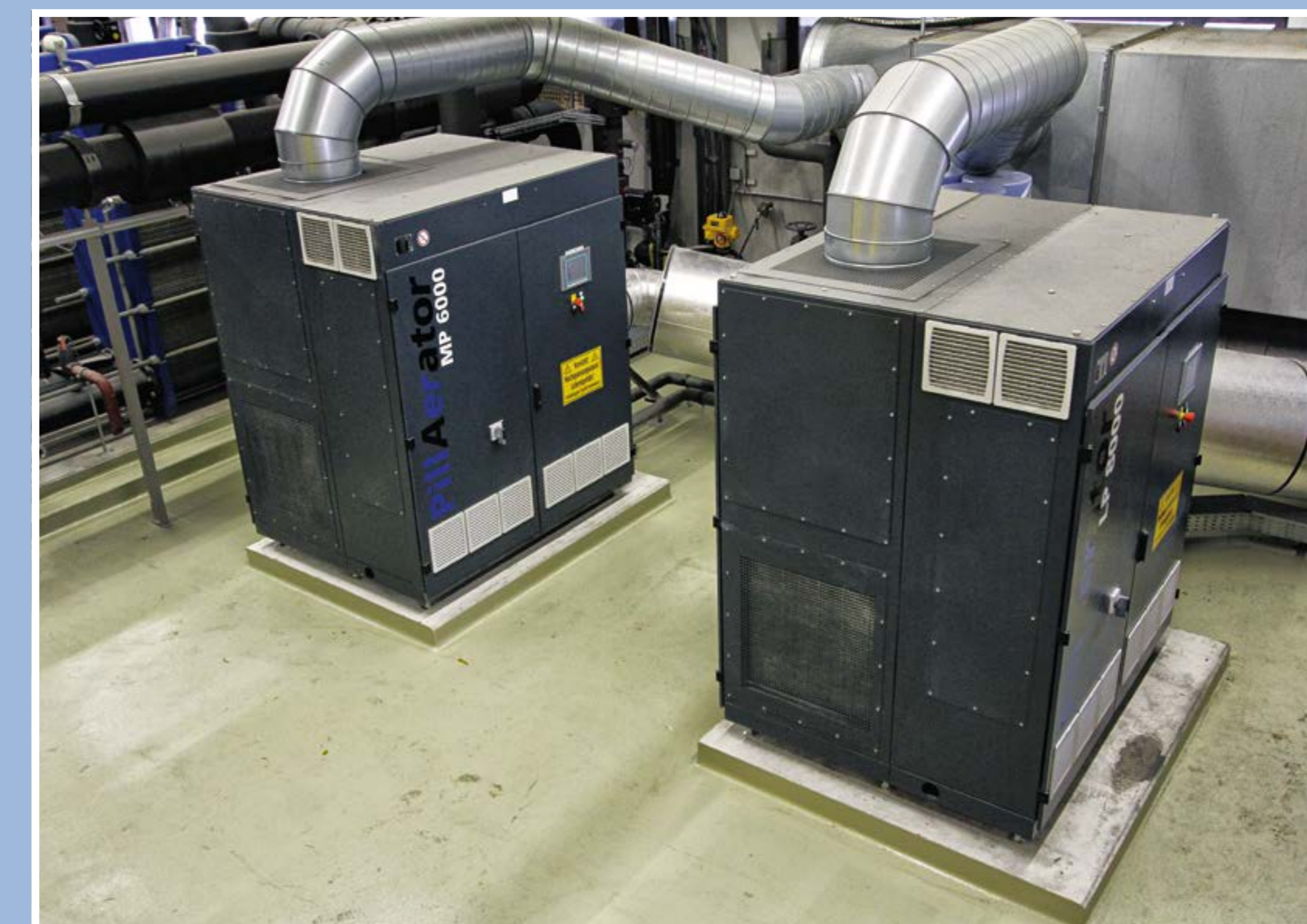
Gebläsestation zur Drucklufterzeugung
