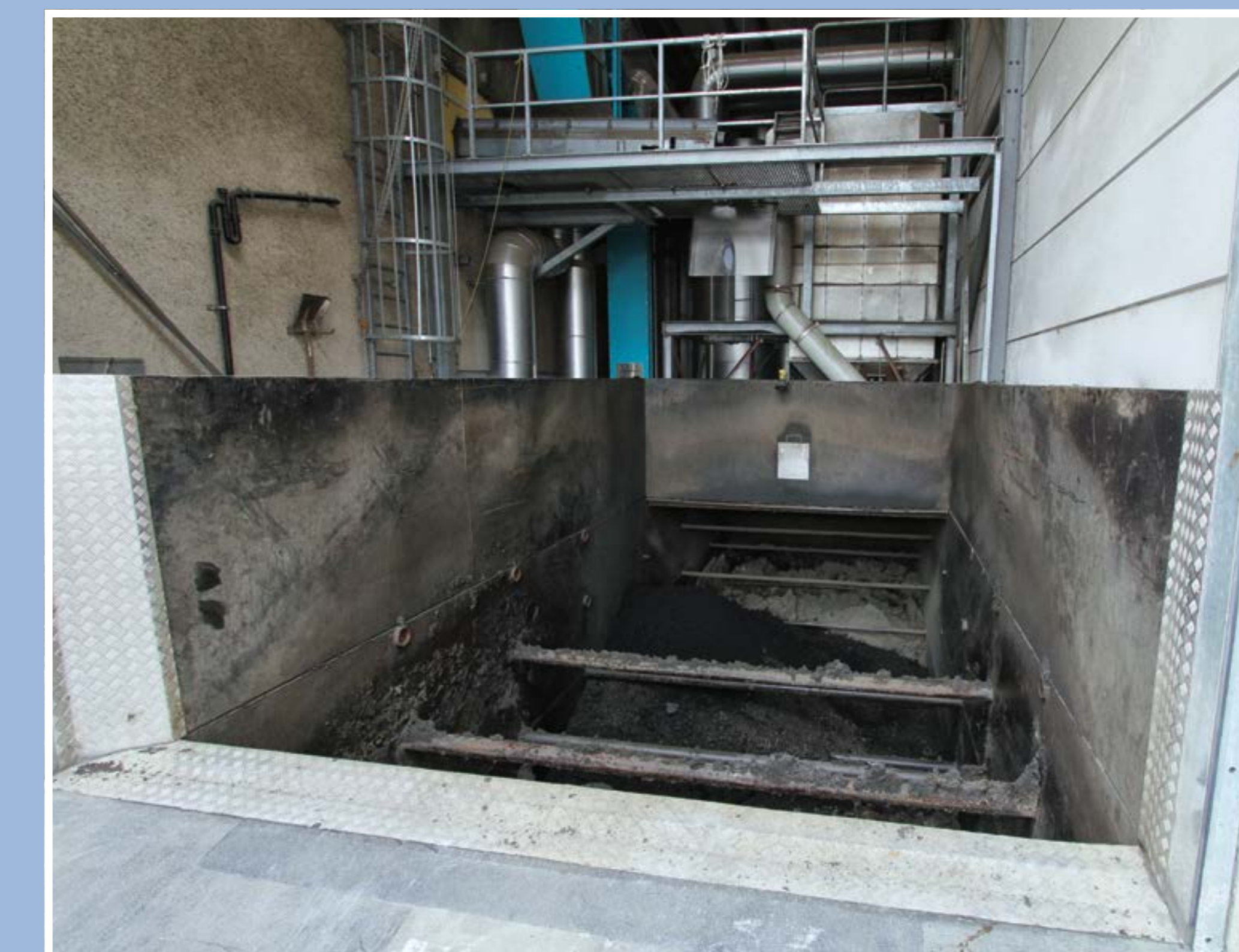
Annahmehunker für entwässerte Schlämme
