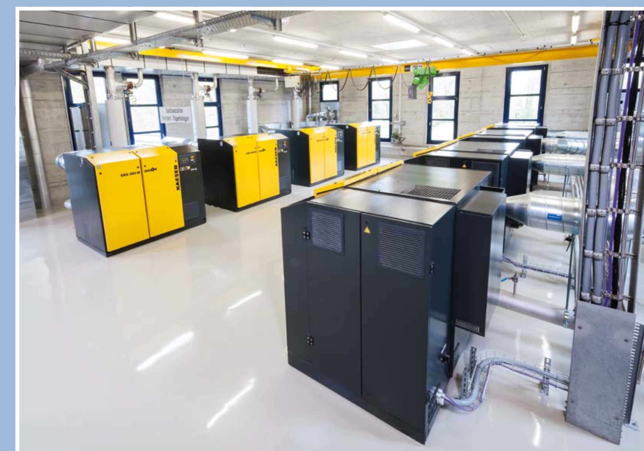
Gebläsestation mit 8 Kompressoren zur Druckluftherzeugung
