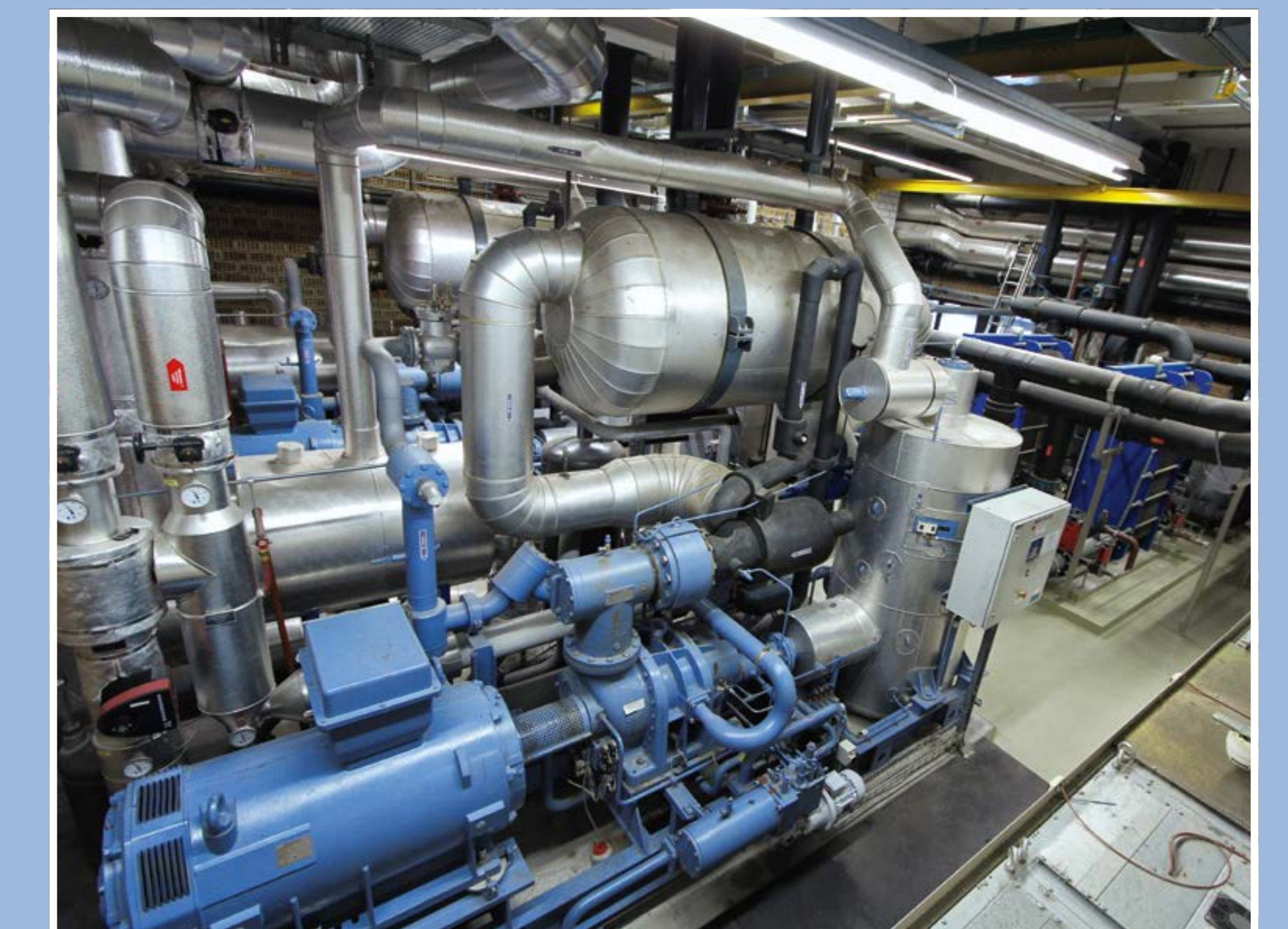
Energieanlagen mit Wärmetauscher und Wärmepumpen
