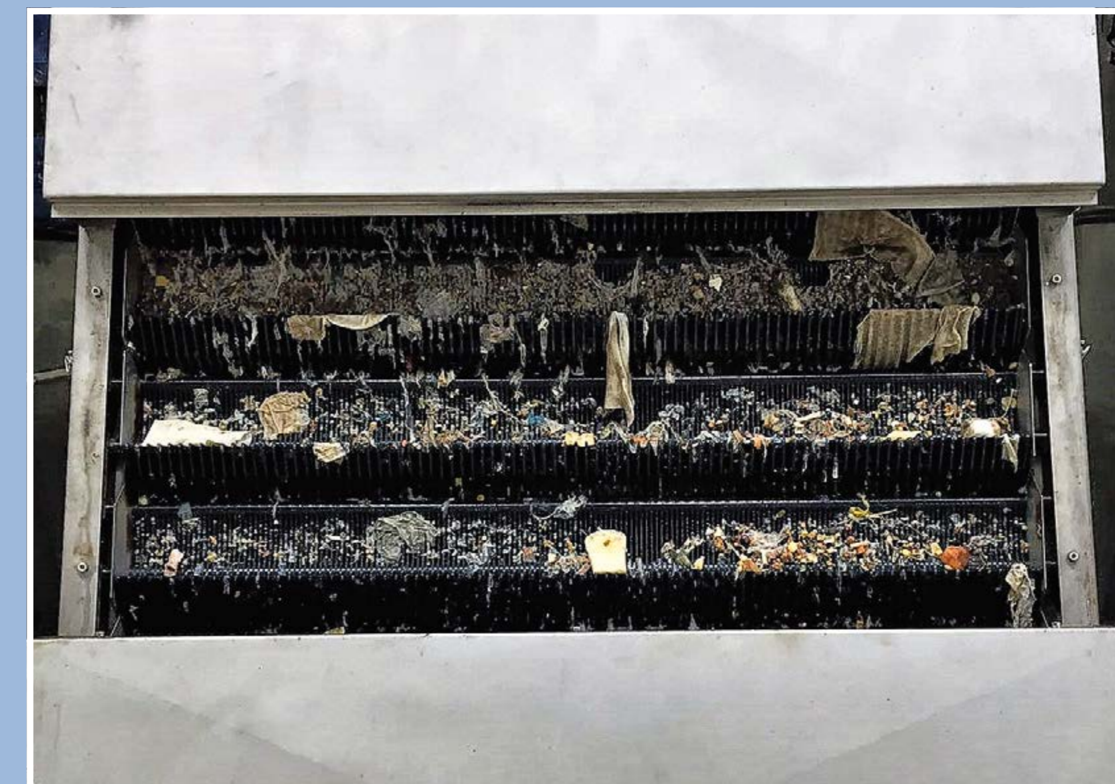
Rechenansicht, ohne Schutzblenden
