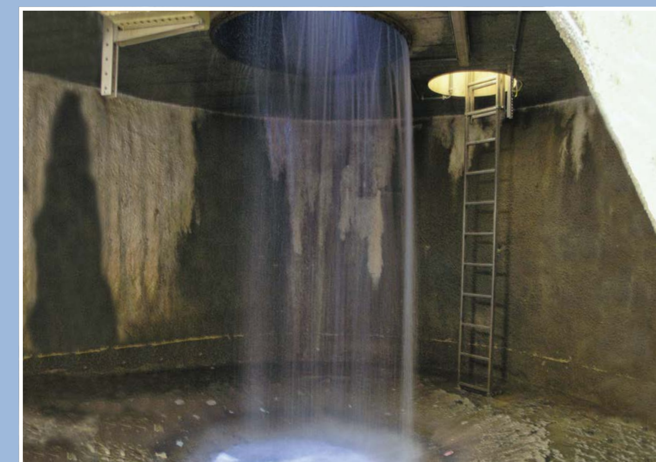
Wirbelfallschacht in Rorschacherberg
