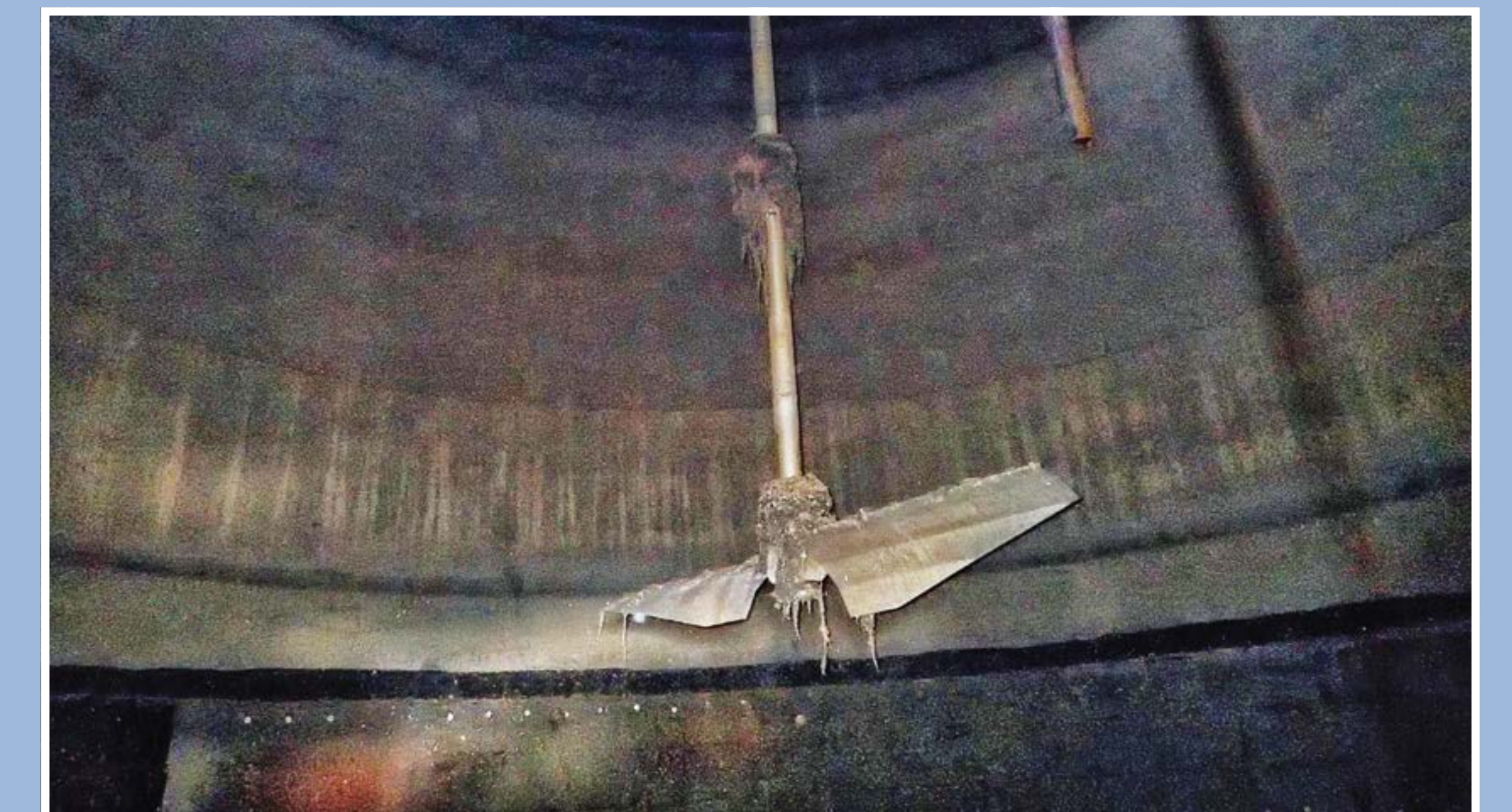
Faulrauminnensicht mit Rührwerktrieb
