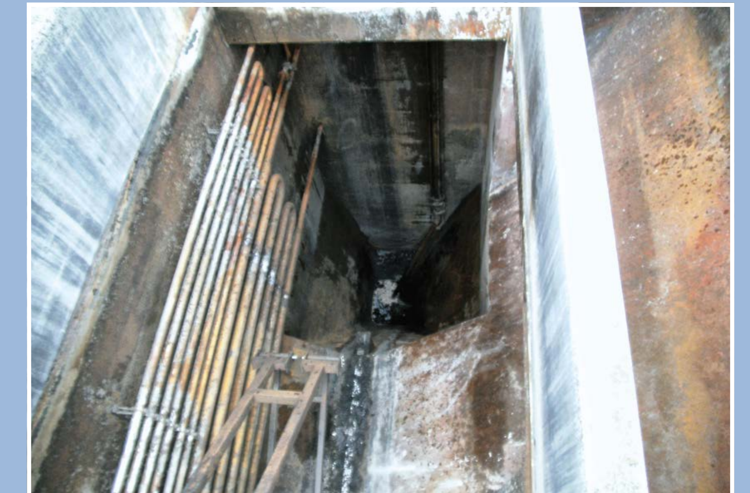
Sandfangtrichter mit Pumpensumpf
