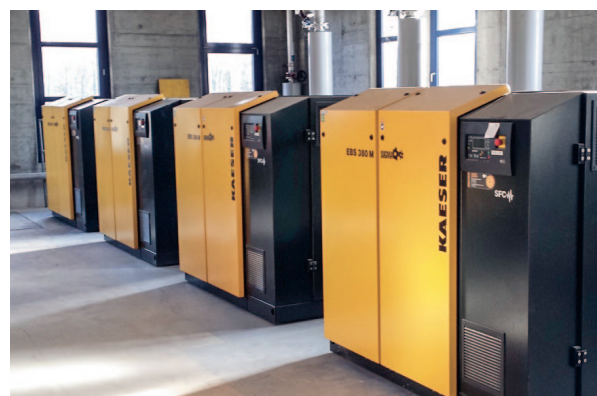
Raum Gebläsestation mit vier der acht neuen Aggregaten
