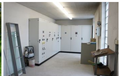
PW Steinlibach – bestehender Betriebsraum
