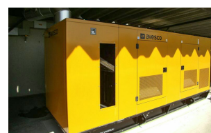
Notstromgruppe unter wetterfester Schallschutzhaube
