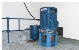
Trockenwetterpumpe zu ersetzen
