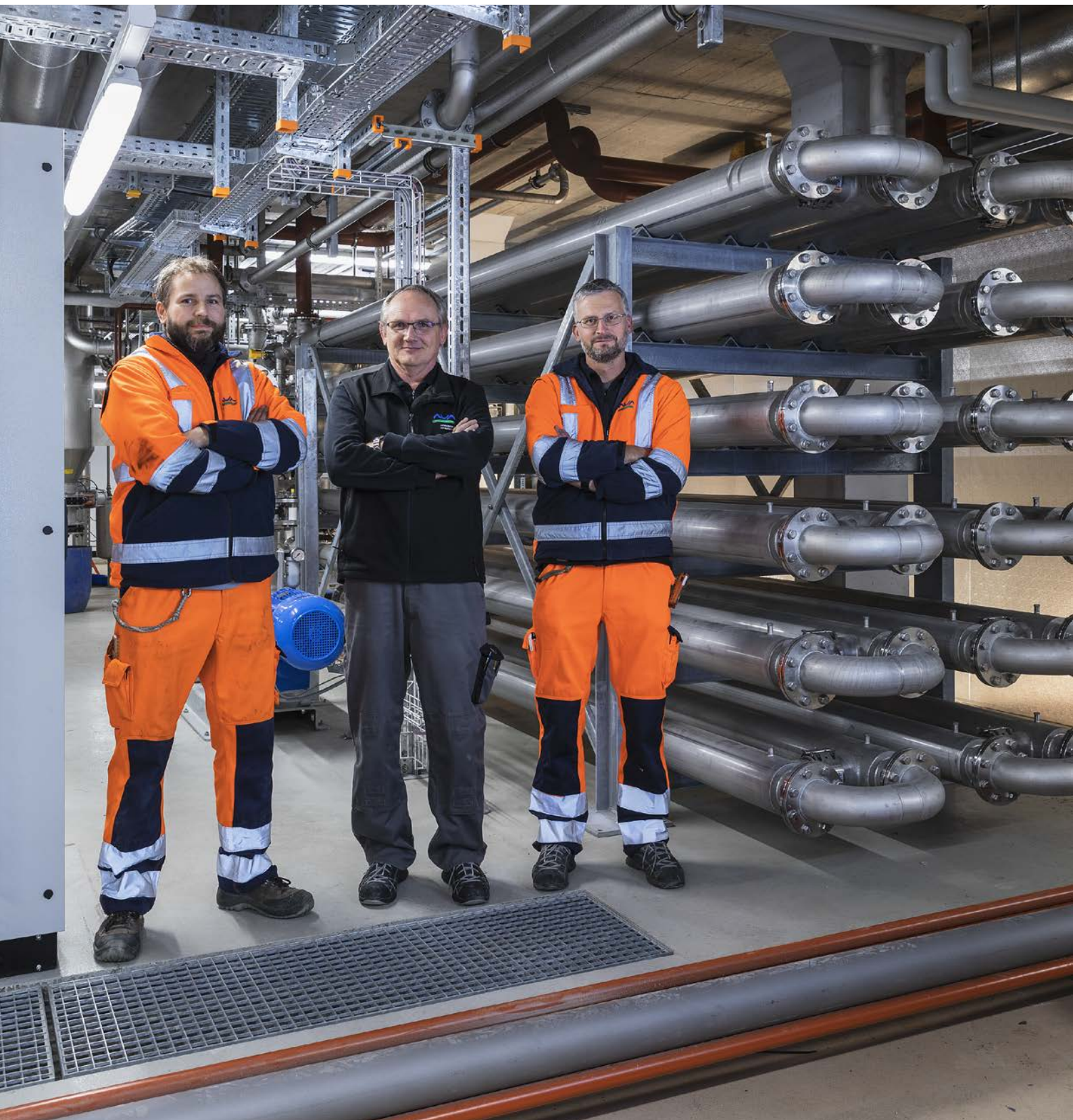
Equipe Elektrotechnischer Dienst vor dem Schlamm-Wärmetauscher
