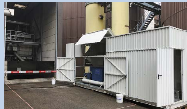
Pilotanlage zur Schlammpellettierung
