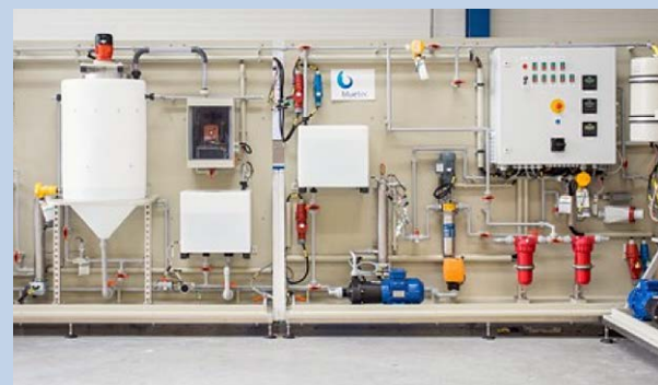
Pilotanlage zur Ammoniakstrippung
