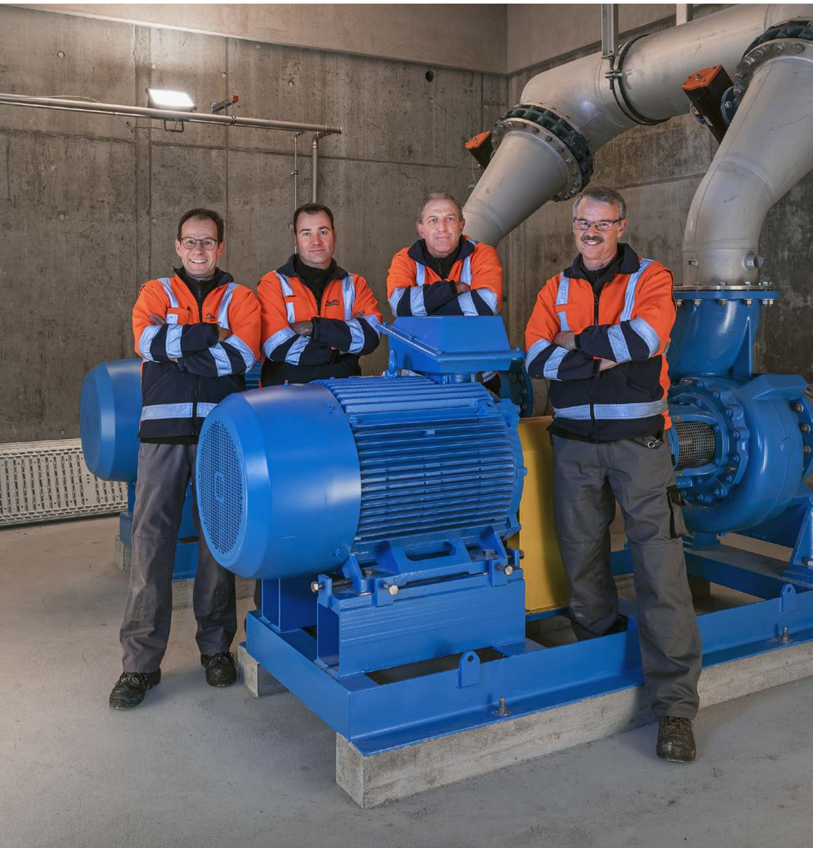
Team Abwasserreinigung bei den Pumpen zur GAK Filterspülung
