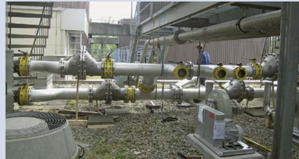
Sicherheit Gasnetz: Erneuerung von Druckerhöhungsgebläsen und Rohrinstallationen mit Ergänzung von Flamm Sperren vor den Gasometern
