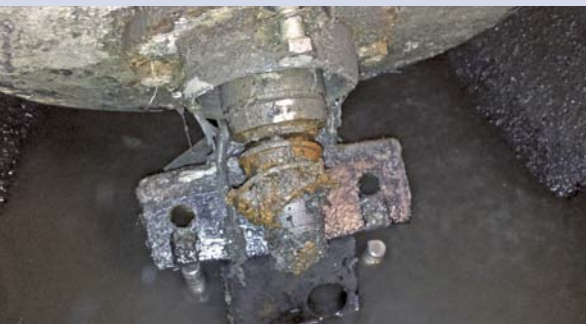
Defektes Lager der Schneckenpumpe
