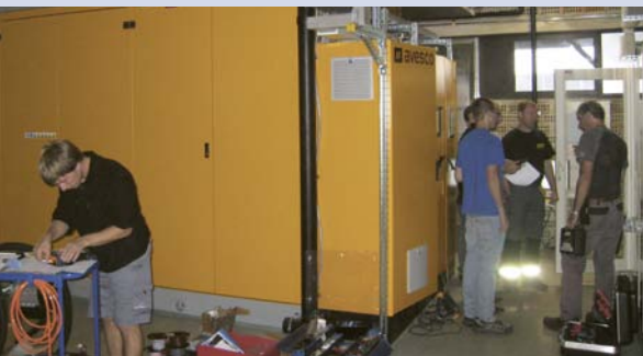
Neues BHKW mit Wärmerückgewinnung aus Abgas und Kapsel
