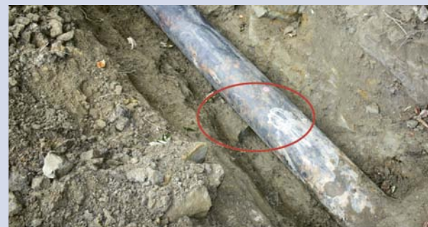
Kanalsanierung: Mangelhafte Rohrbettung
