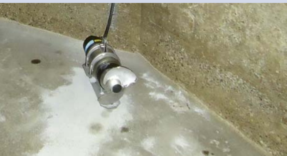
Neue Rührwerke im Regenbecken Freibach
